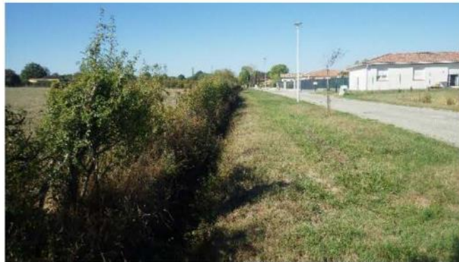
Photo 1 : route dégradée par le ruissellement
